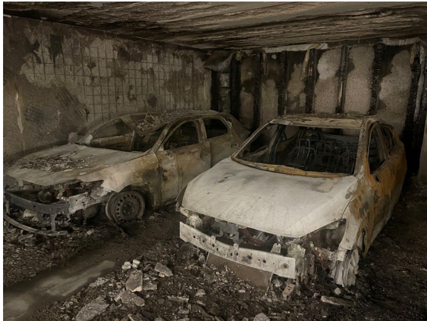
Billede 4. Brandforløbet i parkeringskælderen - bemærk afskalning af dækklag
